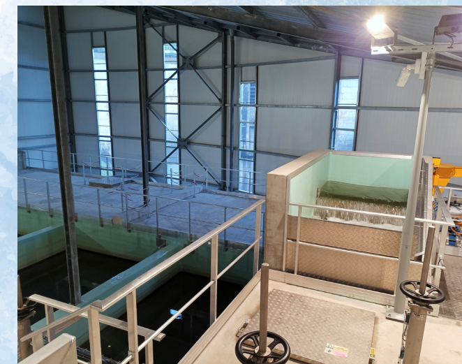
Vue de l'intérieur de l'usine : Arrivée de l'eau brute et bassin de filtration
